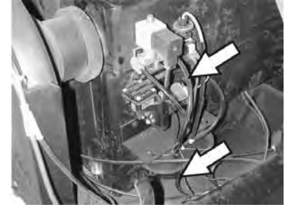
وصلات خراطيم إلى مضخة تفريغ ووحدة تفريغ (وحدة تخزين)
